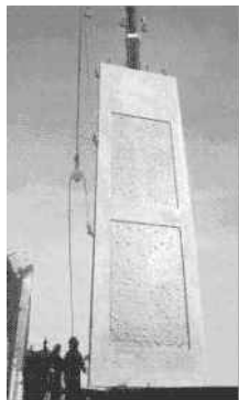
Após atingirem a resistência necessária, os painéis são erguidos com o auxílio de guindastes apropriados
